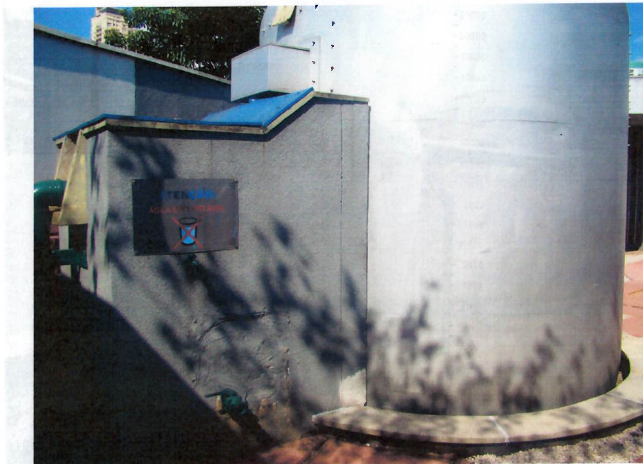
Figura 8 – Saída do efluente tratado
